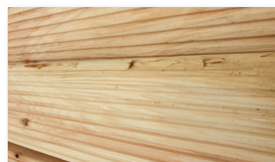
Hobelfehler im Sichtbereich
