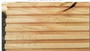
Trockenrisse in der Oberfläche
