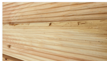
Hobelfehler im Sichtbereich
